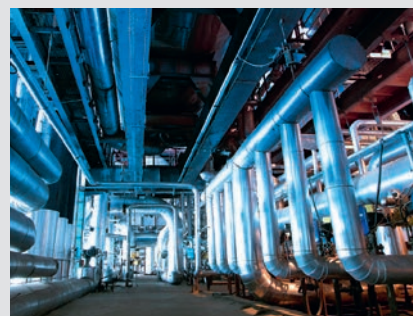
重要なインフラストラクチャの非破壊検査。
